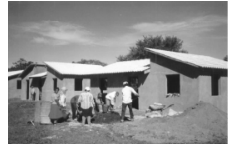
La participación en las labores de construcción de los beneficiarios de las viviendas, así como el aprovechamiento de los ecomateriales existentes en la zona, hacen mucho más viables los proyectos de Grupo Sofonias.
